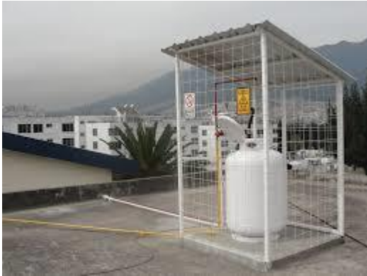
Figura 3. Estructura para almacenamiento de tanques de GLP.
