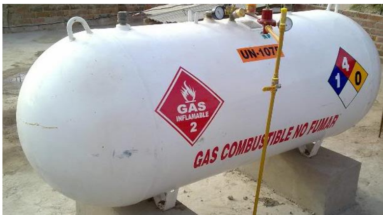
Figura 2. Identificación de peligro de los tanques estacionarios de GLP.
